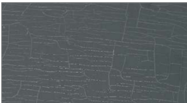
A estrutura foi toda degradada pela radiação UV.
